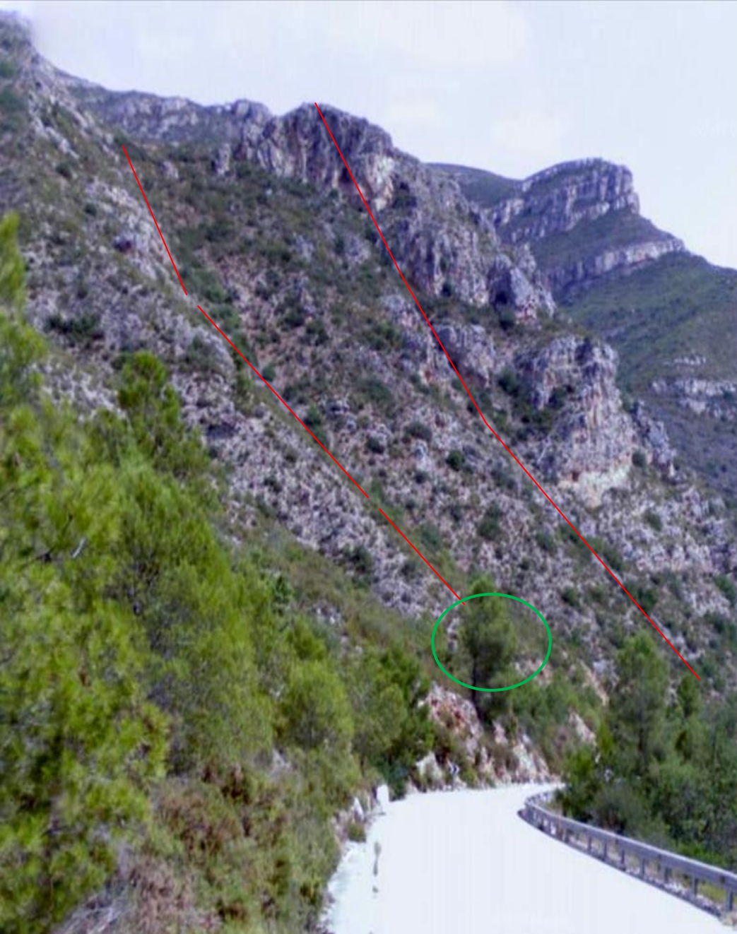
Curva con laderas inestables y con fallas
